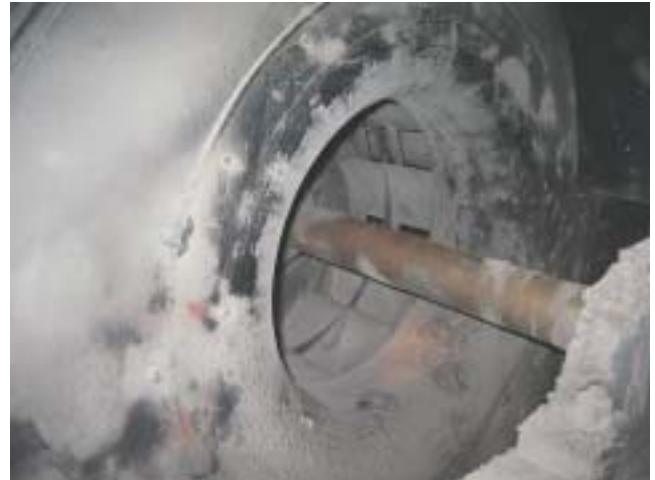
Photo 2. Accumulation de poussières sur un ventilateur à l'intérieur d'une unité de ventilation
